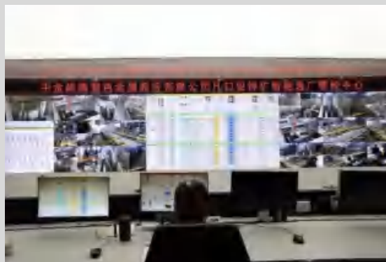
凡口矿智能选矿厂管控中心
